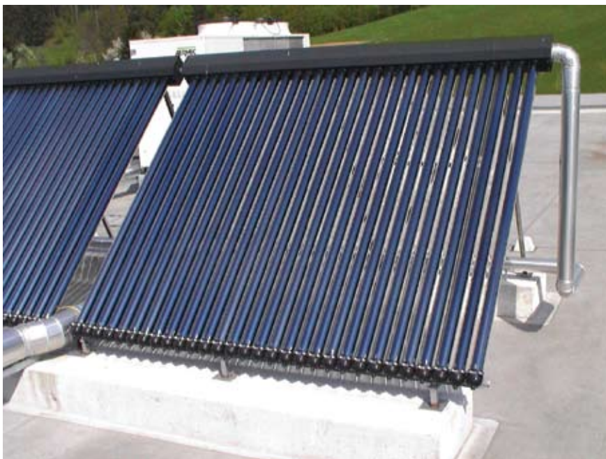
Slika 14: Primer sončnih kolektorjev za ogrevanje sanitarne vode
