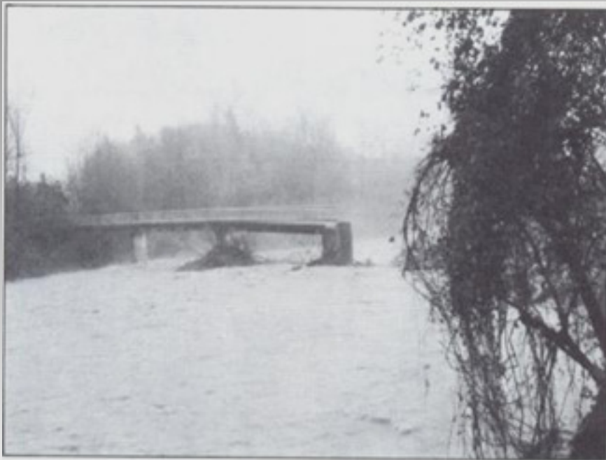
Slika 12. Homec—Radomlje: delno porušen most
