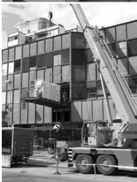
Slika 1: Nova naprava CC800/9 sinOx ML (zgoraj) in transport le-te v prvo nadstropje zgradbe v Domžalah, v kateri je Center za trde prevleke (spodaj)
