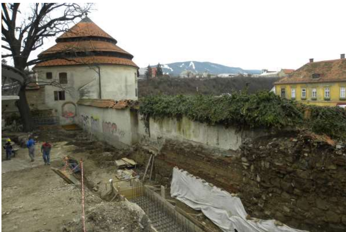
Južni del zahodne obzidne stranice z notranje strani. Obnova nikoli ni bila dokončana. Sedanje stanje nujno terja ustrezne dopolnitve.
