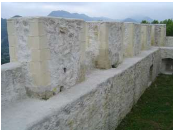
Primer zaščite vrhnjega dela obzidja s cinami in psobrani z armiranobetonskimi oblogami na razvalinah Starega gradu Celje
