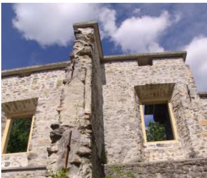
Primer zaščite vrhnjega dela obzidja z armiranobetonskimi ravnimi elementi na razvalinah dvorca Brdo pri Lukovici
