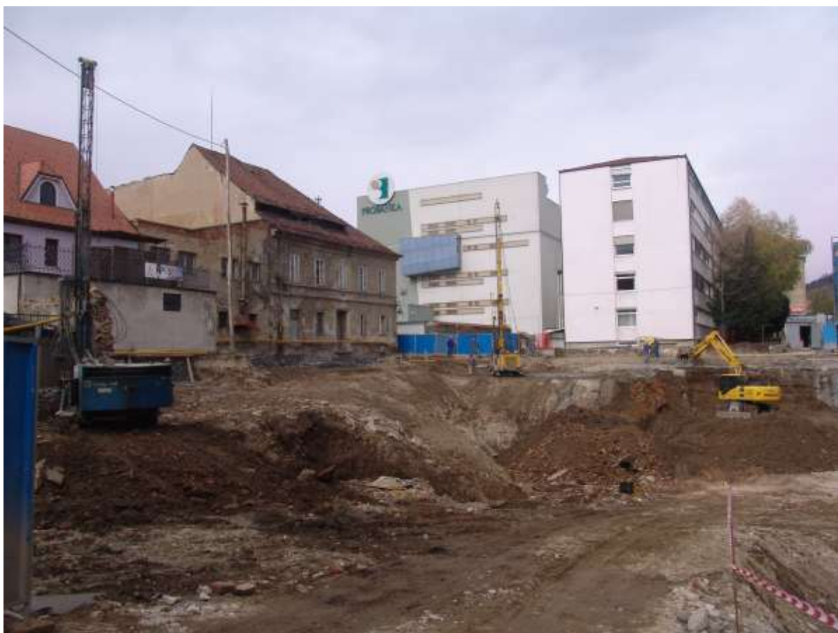
Mariborsko mestno obzidje so že v 13. stoletju na treh straneh, razen ob Dravi obdali z Jarkom. Širina in globina jarka se je lepo pokazala leta 2010, med izgradnjo stavbe Centrum v Svetozarevski ulici.
