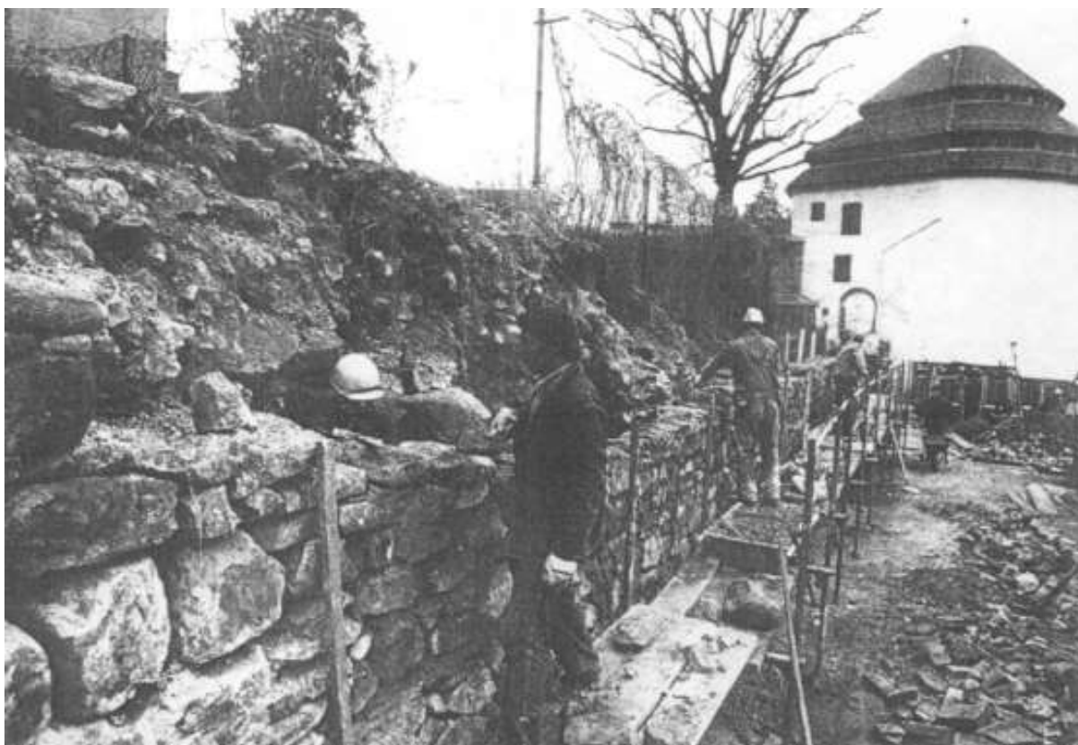
Ponovna gradnja dela mestnega obzidja ob Sodnem stolpu v Mariboru leta 1979. Arhiv ZVKDS OE Maribor.
