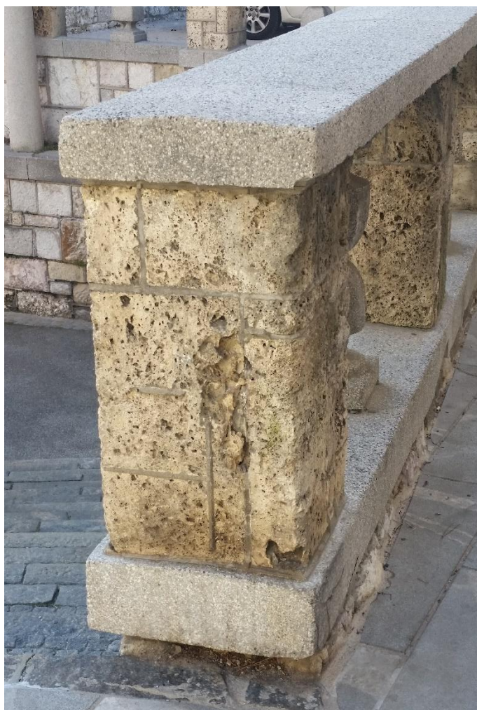
Slika 33: Odkrušena ograja na Roženvenskem stopnišču (foto: U. Žun)
