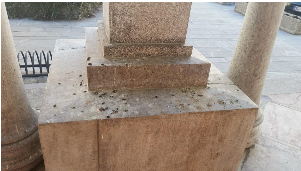
Slika 27: Neprimerni ptičji iztrebki (foto: U. Žun)
