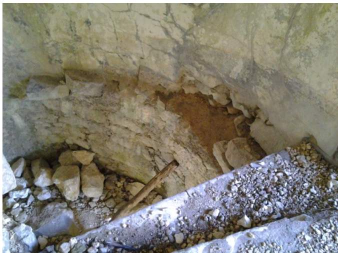
Slika 18: Porušeno stopnišče (foto: U. Žun)
