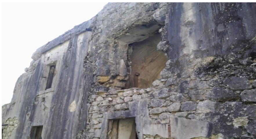
Slika 21: Razpadajoča okna (foto: U. Žun)
