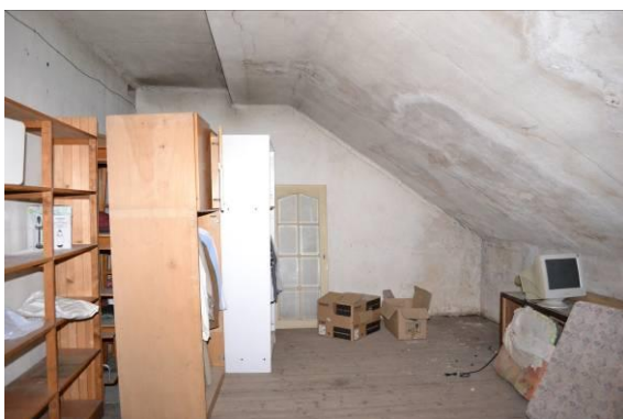
Slika 24: Madež kot posledica odtekanja vode
