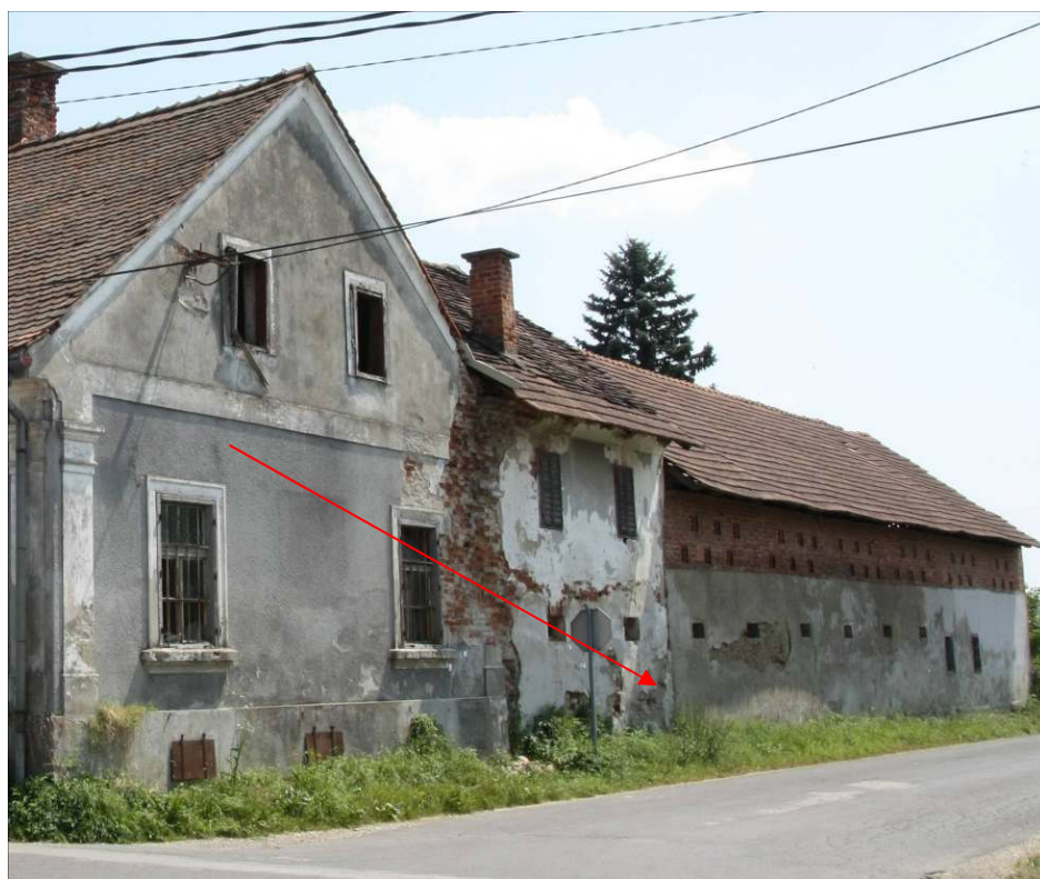
Zid na Z fasadi je v delu pod kaščo in južno od njega rahlo napet navzven, kar kaže na statične probleme.
