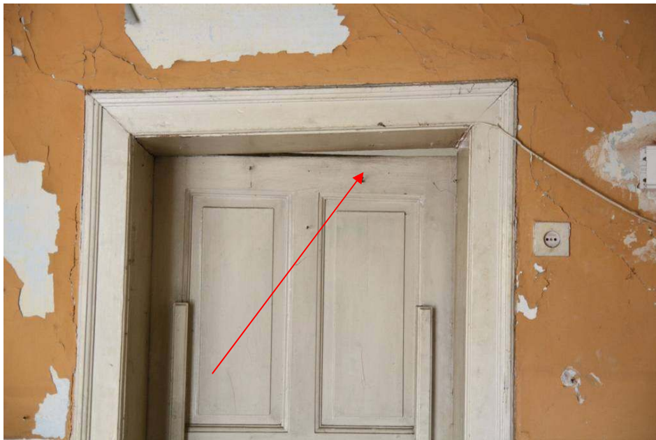
V pritličju stanovanjskega dela so vidne posledice neenakomernega posedanja zidu, zaradi katerega se je zamaknil vrtni okvir, kar se vidi kot špranja pri zaprtih vratih.
